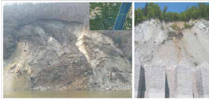
Figure 4 : Eboulement de Liubotina et travaux d'aménagement et de consolidation du versant.
